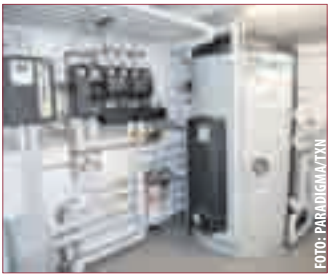
HEIZUNGSMODERNISIERUNGEN werden attraktiv gefördert. Der Paradigma-Förderservice leistet hierbei von der Information bis hin zur Antragstellung Hilfe. (ttn)
