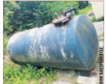
ALTE ÖLTANKS bieten viele neue Speicherkapazitäten.
