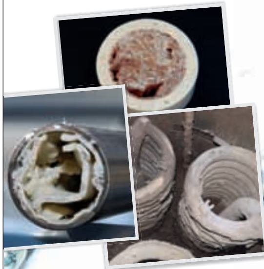
1) verblocktes Kunststoffrohr, 2) verblocktes Edelstahlrohr, 3) Warmwasserspeicher
