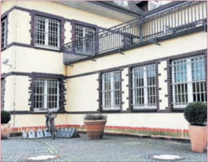
DIE HORIZONTALSPERRE gegen aufsteigende Feuchtigkeit im Gebäude.
