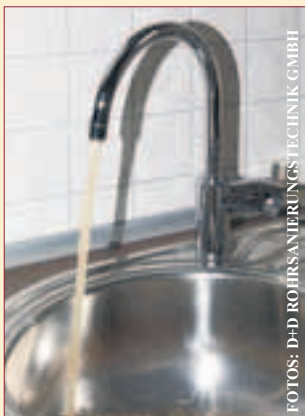
Vor der Sanierung: Der erste Schwung Wasser ist von den Inkrustierungen deutlich braun eingefärbt, das nachfließende Wasser wird etwas heller.
